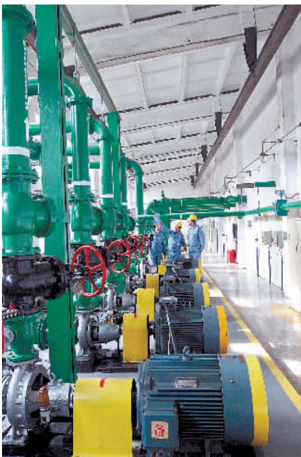
天津石化持续多年在设备管理工作中推行自主管理,逐步建立起了装置企业标准。目前,该公司已将自主管理示范区从局部拓展到单元和装置,收到了现场目视化标识规范、巡检标准化、目标管理具体化的效果。图为天津石化水务部职工正在巡检设备。(董波摄)
